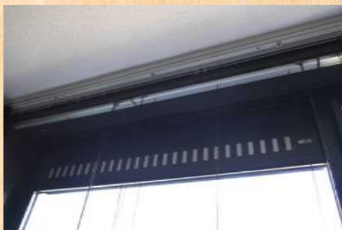
Ventilatioerooster op het glas • Vaak dichtgezet
