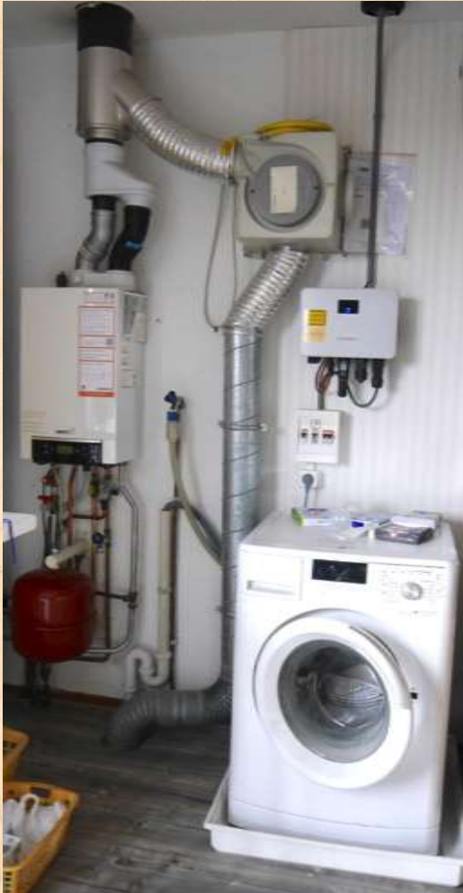
Voorbeeld installatieruimte met cv-ketel, MV box, omvormer en wasmachine op 2eV (type D2)
